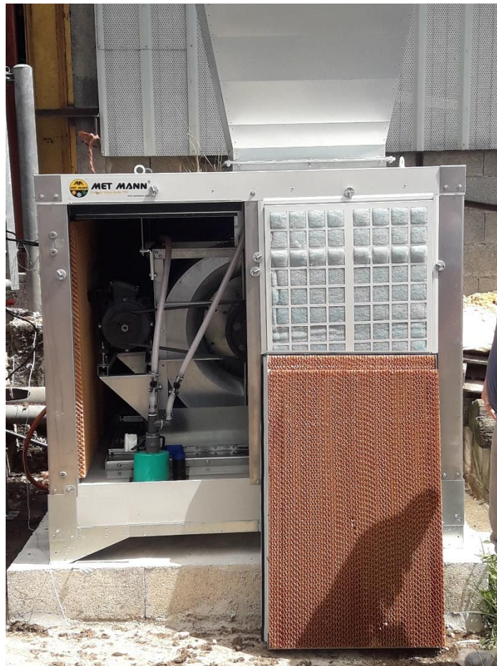
Le caisson comprenant le moteur et le système de refroidissement d'air
